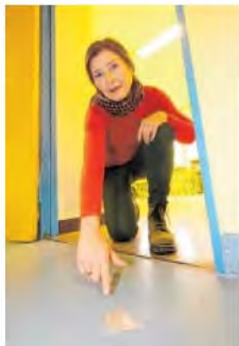
Der Boden platzt auf: OGS-Leiterin Gabi Schubring zeigt eine der vielen Schadstellen.
